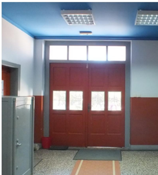
Ilustracija 68 – Postojeća ulazna vrata s manjkavom izolacijom
