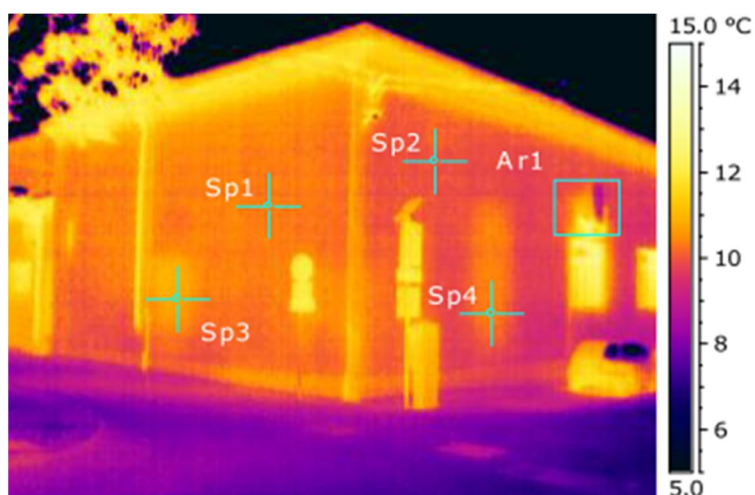
Ilustracija 65 – Termografska snimka IV vanjske fasade Upravne zgrade Općine Puntar 72
