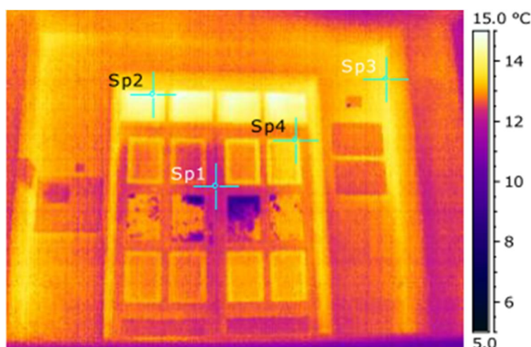
Ilustracija 67 – Termografska snimka VI vanjske fasade Upravne zgrade Općine Punaat 74
